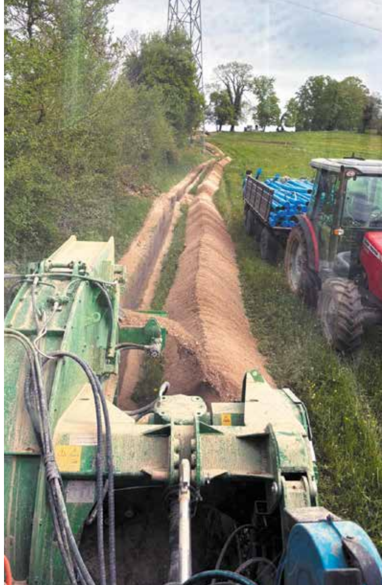
Urs Erne verlegte die Rohre in einen Graben, das der Unternehmer GTechniques mit der Grabenfräse ausgehoben hatte.
